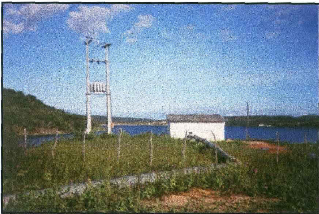
Foto 10 – Estação de bombeamento existente (vê-se no detalhe uma subestação de 225 KVA que pode ser aproveitada).
