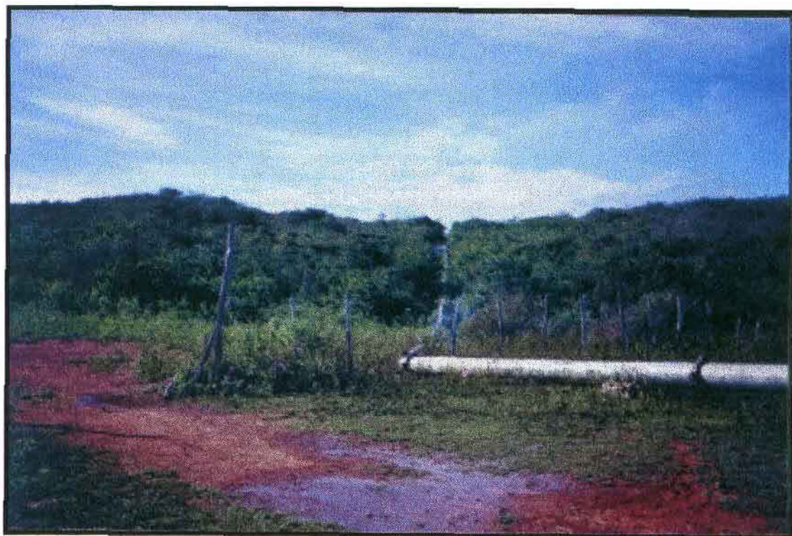
Foto 04 – Vista longitudinal da adutora existente, observando-se diversos vazamentos.
